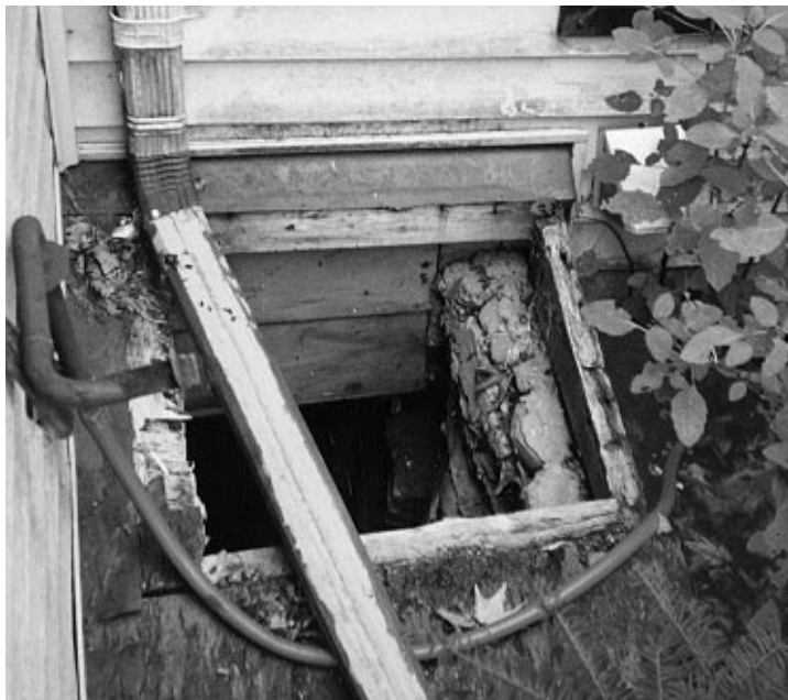
Broken cellar bulkhead door
